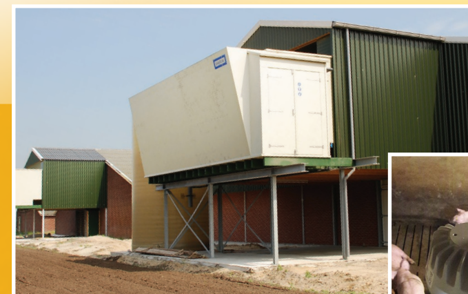
Luchtwassers en luchtfilters
